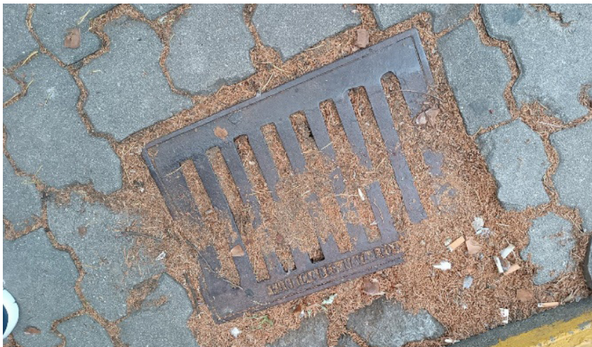
Figura 6. Detalle del estado de la rejilla ubicada en el interior del recinto de la facultad
