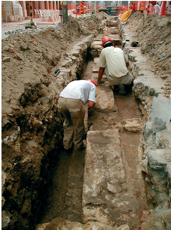
Ilustración 47. Antiguas tuberías pertenecientes al suministro de agua y gas. Su instalación dañó gran parte de las estructuras de la calle Domingos José Martins.
