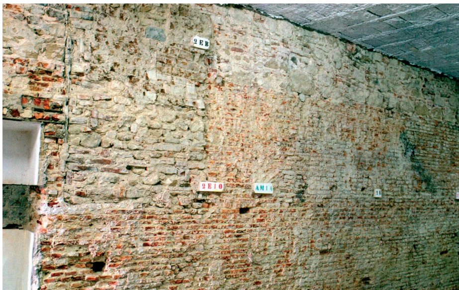
Ilustración 42. Pared de ladrillos levantada durante la construcción de la casa vecina al terreno donde más tarde sería instalada la sinagoga. Obsérvese la ampliación posterior.
