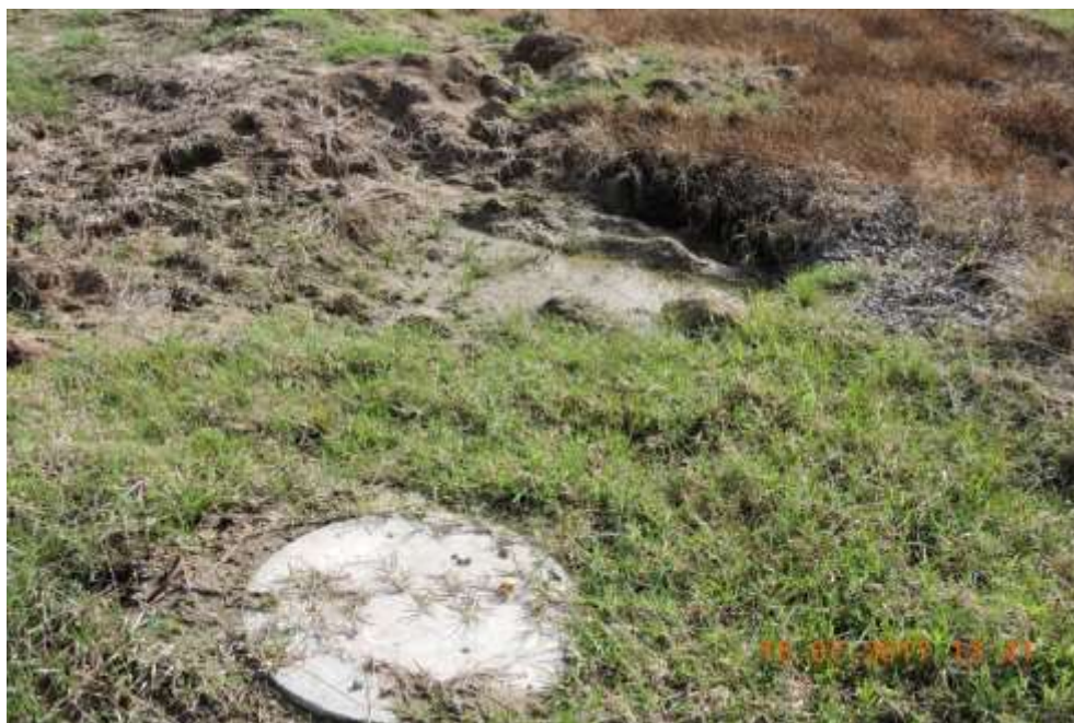
FOTO 3 - SISTEMA FOSSA SÉPTICA-SUMIDOURO DOMINANTE NO ASSENTAMENTO. OBSERVA-SE QUE A ÁREA DO SUMIDOURO ESTÁ TRANSBORDANDO EM FUNÇÃO DA BAIXA PERMEABILIDADE
