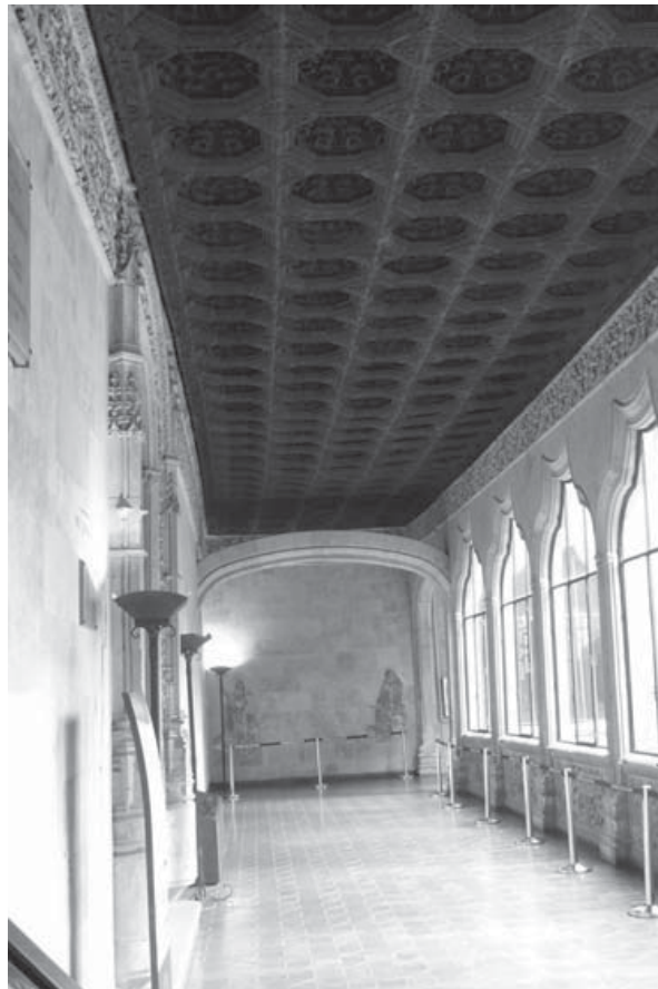
Fig. 3. Claustro alto, donde se aprecia el desplome de la pared Este
