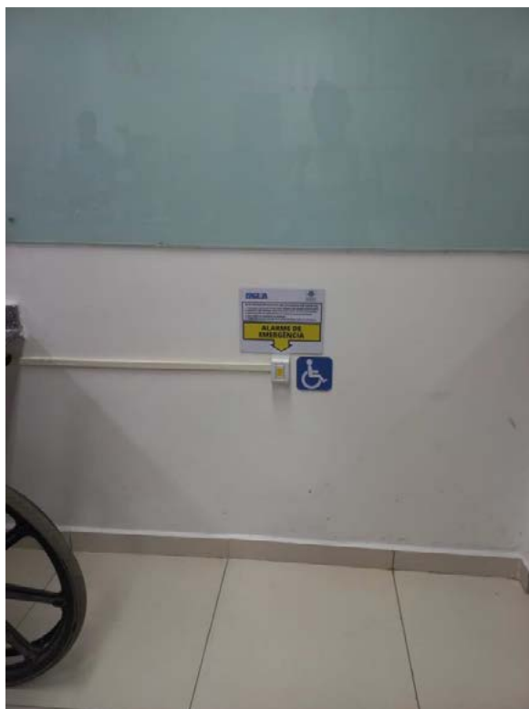
FIGURA 4. Alarma de emergencia
