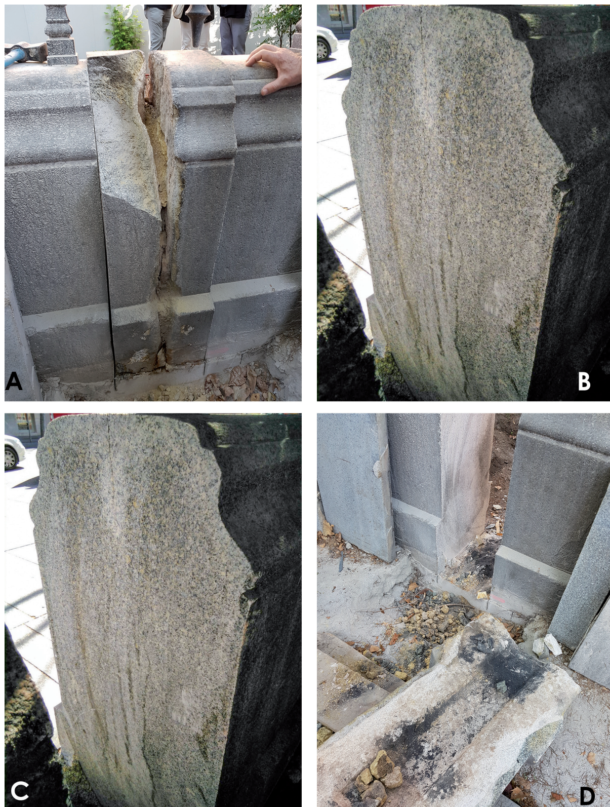
Figura 7. A) Relleno de junta con mastic de azufre y penetración de los compuestos en el interior del sillar. B) Presencia de compuestos de azufre en los poros del granito en zonas en las que éste mantiene su cohesión, a más de 15cm de la junta original. C) Sistema de anclaje de las sierras radiales en las zonas previamente afectadas por el ataque químico. D) Detalle de la machihembra original y restos del mastic de azufre y limaduras de hierro.
