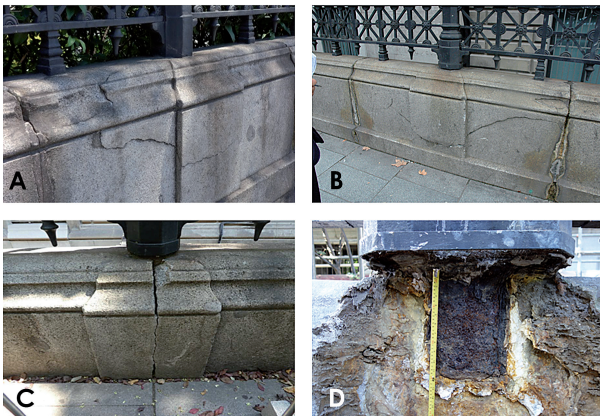
Figura 2. A-C) Detalles de basas fracturadas. D) Detalle de la corrosión de la camisa de hierro del pilastrón este de la calle de la Armada Española.
