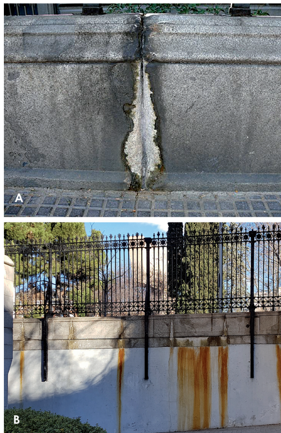
Figura 4. A) Junta profundamente alterada con descohesión granular y costros generadas por el ataque químico. B) Vista interior del cerramiento de la calle Armada Española donde se aprecia que el ataque químico comienza a afectar a los sillares inferiores, y se generan pátinas de compuestos de hierro.
