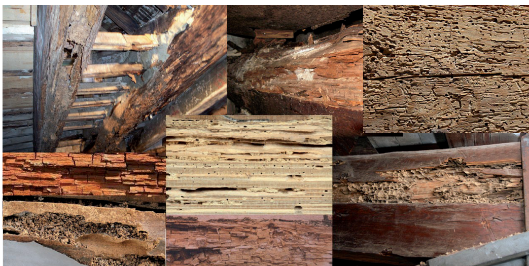
Figura 17. Degradación de la madera
