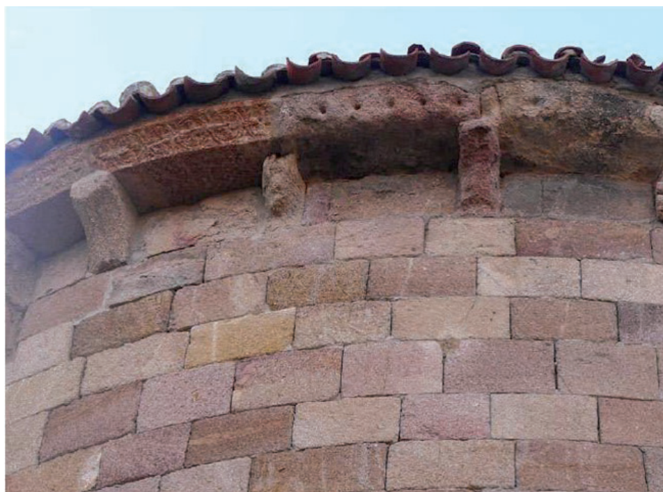
Figura 35. Ábside central. Detalle de la cornisa en 2009. Se aprecia el importante deterioro de los sillares de cornisa y la presencia de costra negra.
