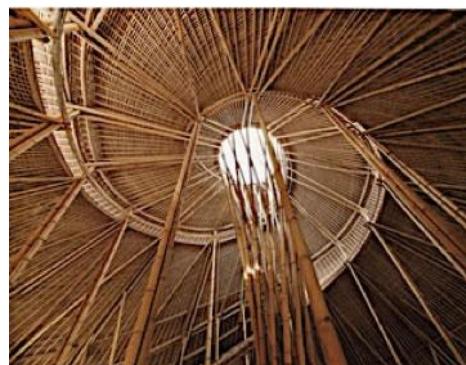
Fig. 150. Estructura de la techumbre de la Green School. Fuente: PT BAMBOO PURE, "Bucles de bambú. Campus y escuela Green School, Bali (Indonesia)". Arquitectura Viva , N.º 137, 2011, p. 53.
